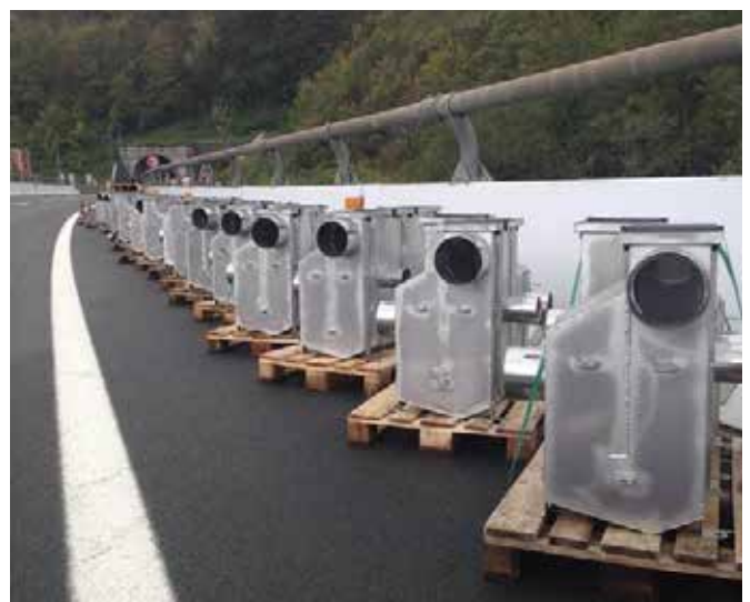
Pozzetti tagliafiamma in acciaio inox installati nella galleria del Cucchero
