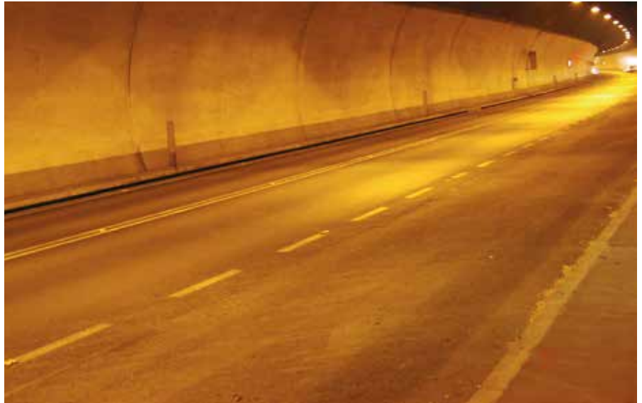
Canalizzazione ACO Tunnel nella galleria del Naturno (BZ)
